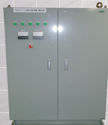
水中モーター試験装置 Under Water Motor Testing Equipment
