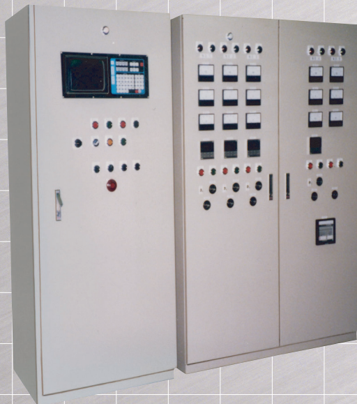
太陽光発電試験システム Solar Power Generation Experimental System
